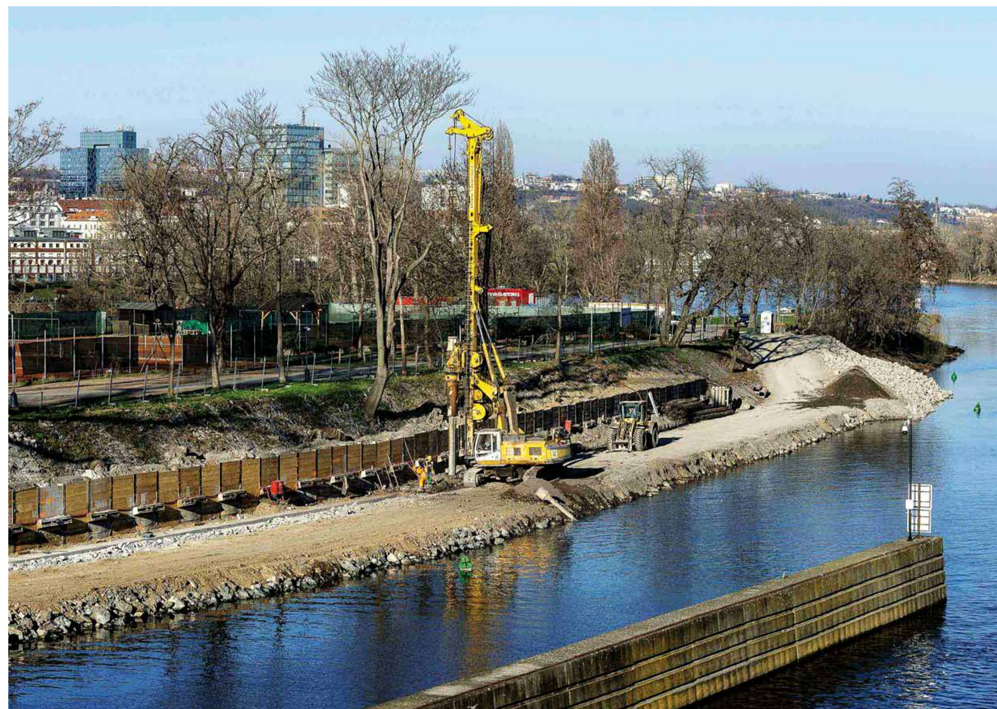
Modernizace rejd plavební komory Štvanice – Remes, Zakládání staveb, 2019, Praha Modernization of the shipping line to the Štvanice lock in Prague. Remes, Michael: Zakládání staveb, Prague, 2019
