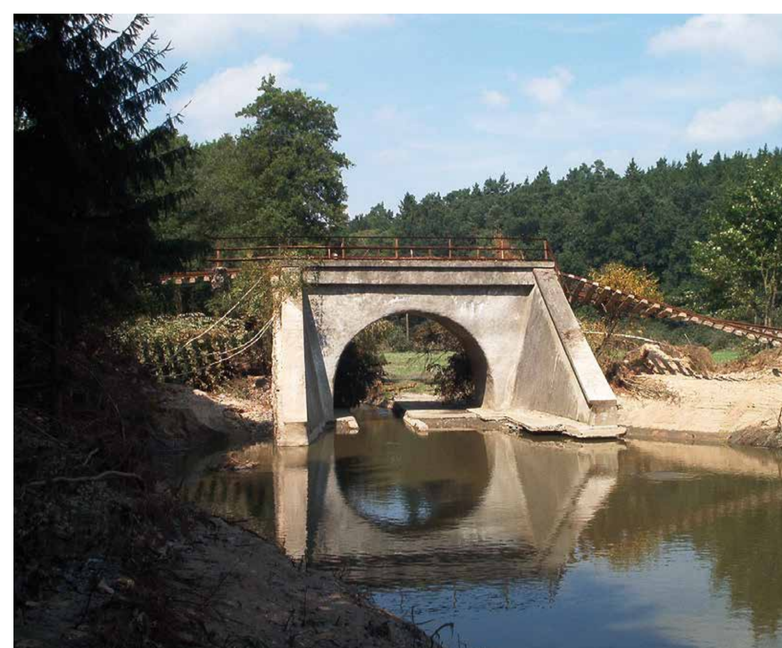
Porušený násep železniční trati při povodních v roce 2002 Failed railway embankment during floods in 2002
