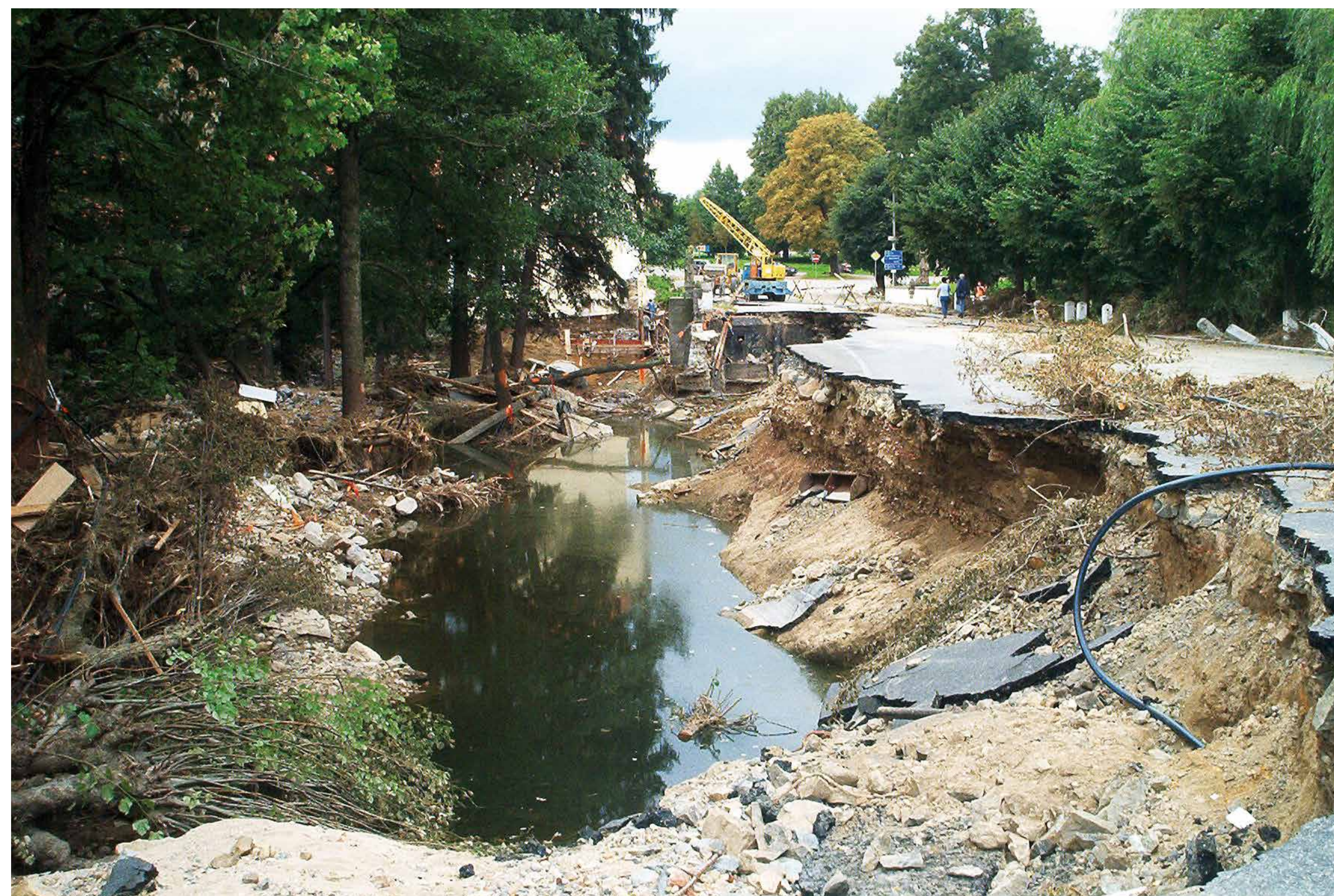
Porušení silnice E 49, vedoucí přes hráz historického rybníka, při povodních v roce 2002 Damaged road E 49 crossing the crest of the small historical dam due to overflowing during floods in 2002
