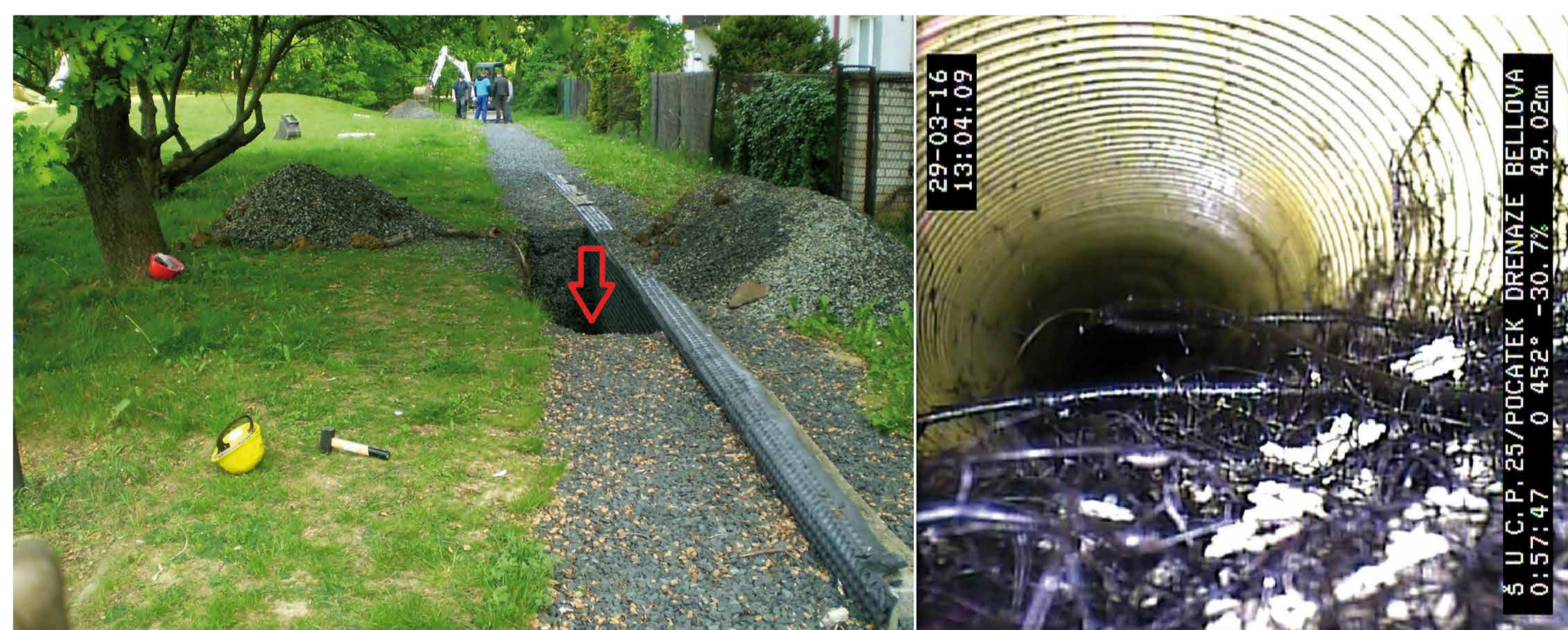
Prorůstání trubkové drenáže kořeny stromů a keřů rostoucích cca 2 m od drenážní roviny. Vpravo je pohled kamerou do potrubí, jehož poloha je označena šipkou Roots of trees and shrubs growing approximately 2 meters away from the drainage plane, penetrating through the tubular drainage. Right: a camera view into the pipe marked with the red arrow in the right-hand photo.
