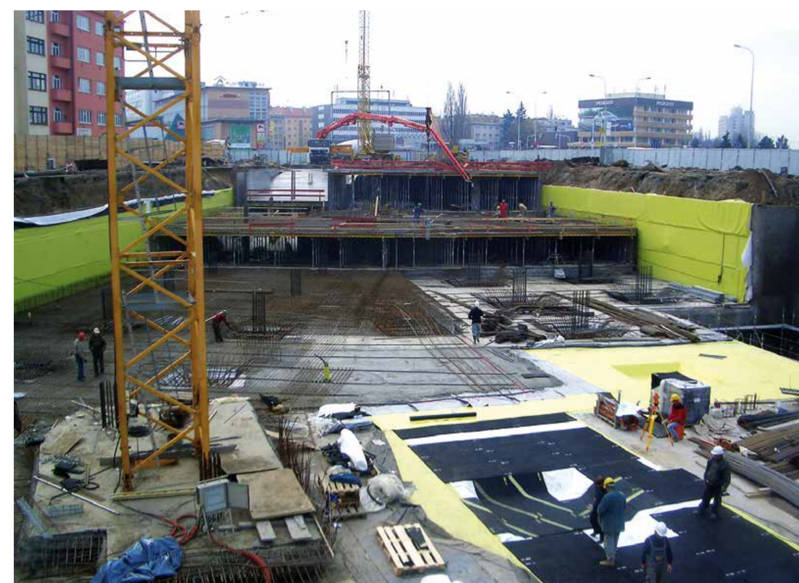
Vyhodnocení požadavků – požadavky na obvodovou konstrukci suterénu (obsahuje izolaci proti vibracím, která se nesmí zaplavit) byly přísnější než na stav prostředí (garáže pro auta) Assessment of requirements – requirements on the basement outer structure (it includes vibration insulation that must not be flooded) were stricter than on building environment (car park).
