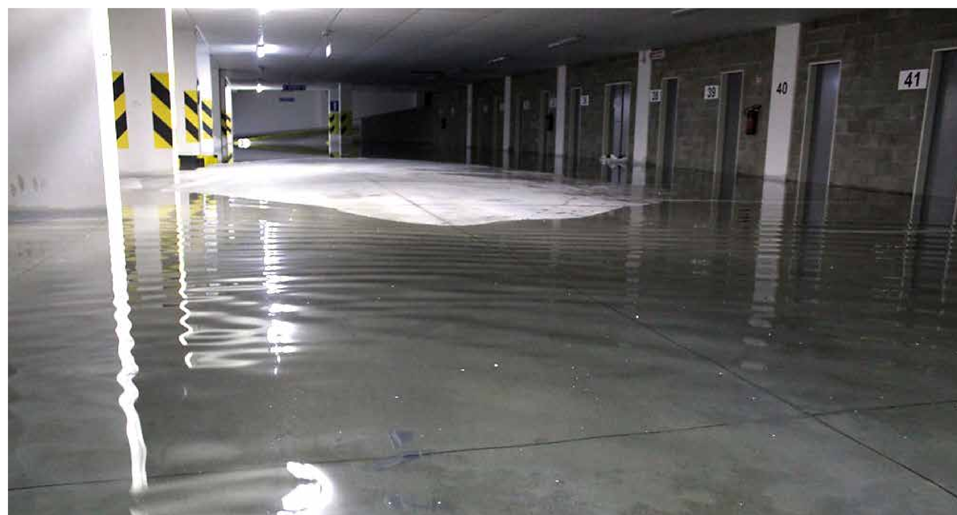
Při konverzi průmyslového objektu na obytný soubor došlo k zásahům do původní hydroizolace suterénu. Skladba podlahy s novým, z interiéru provedeným povlakem nemohla odolat vzltlaku vody při vzednutí toku blízké Vltavy. The old basement waterproofing was compromised during the conversion of this industrial building into a residential complex. The floor slab makeup with a new, interior-applied floor membrane could not resist the vertical hydrostatic uplift when the nearby river Vltava surged.
