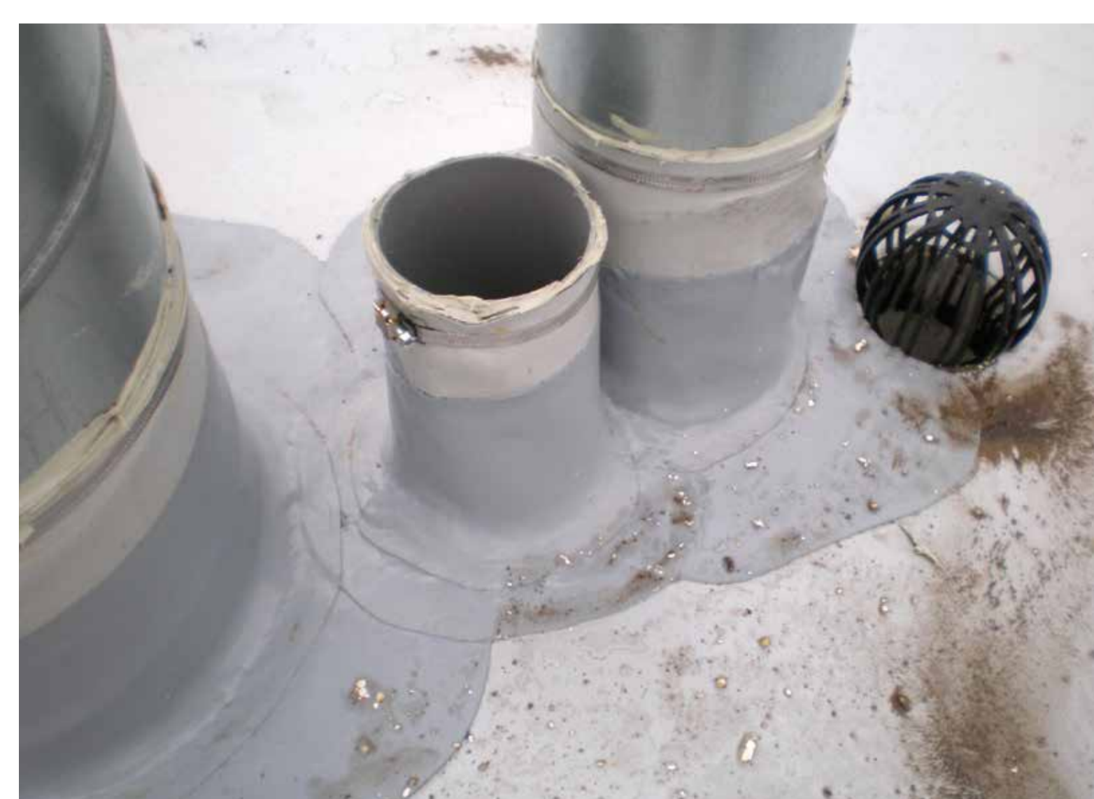
Tvarové a konstrukční řešení objektu – chybně navržené neopravitelné shluky konstrukcí propustujících hydroizolaci střechy Form and structural design – improper design of nonrepairable groups of structures penetrating the roofing membrane
