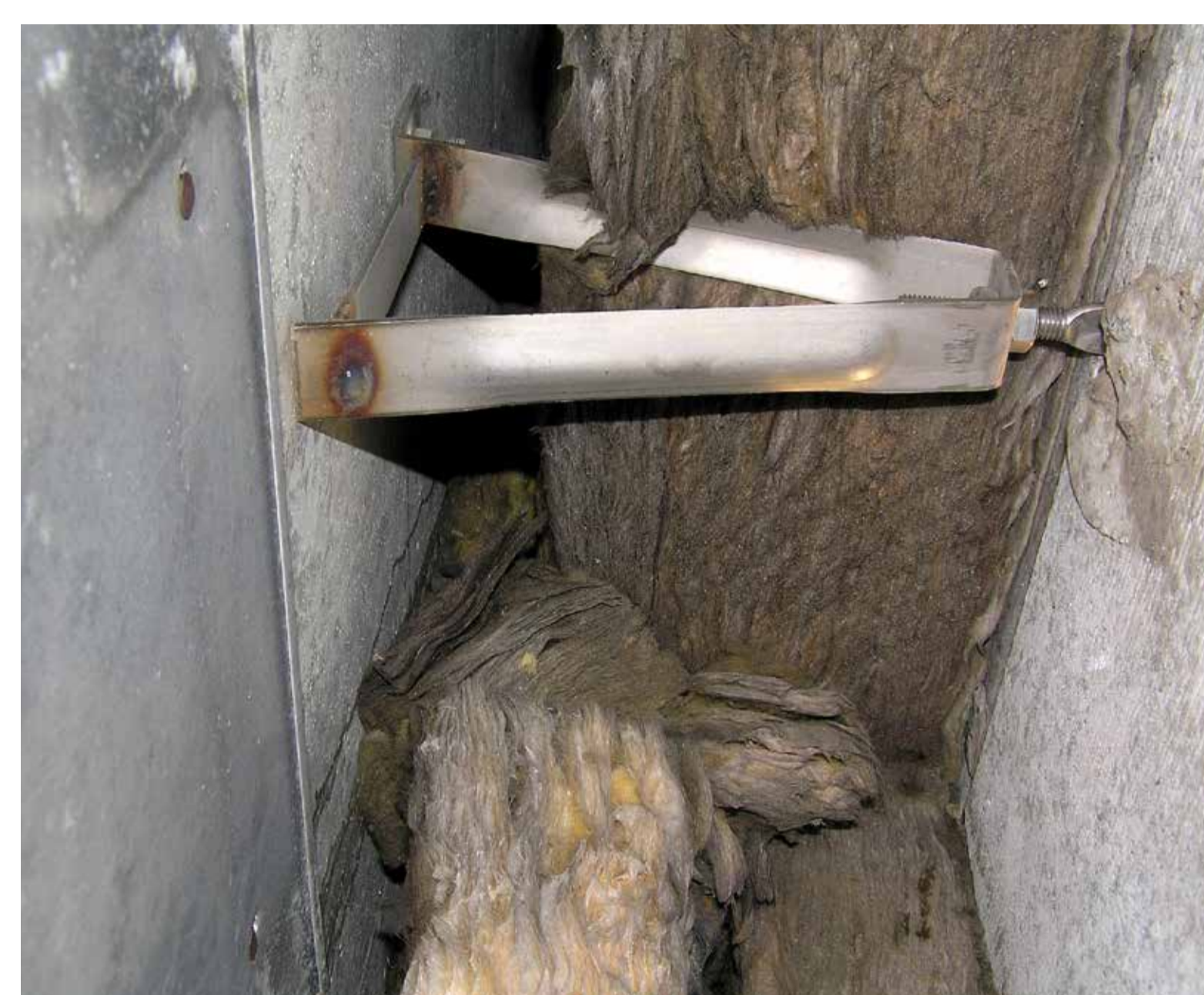
Tepelné izolace působením vody pronikající obkladem zdegradovala a odklonila se od stěny směrem k obkladu – Archiv hl. m. Prahy Thermal insulation degraded due to water leaking behind the veneer and deflected away from the wall towards the veneer – The Prague City Archives, the Czech Republic
