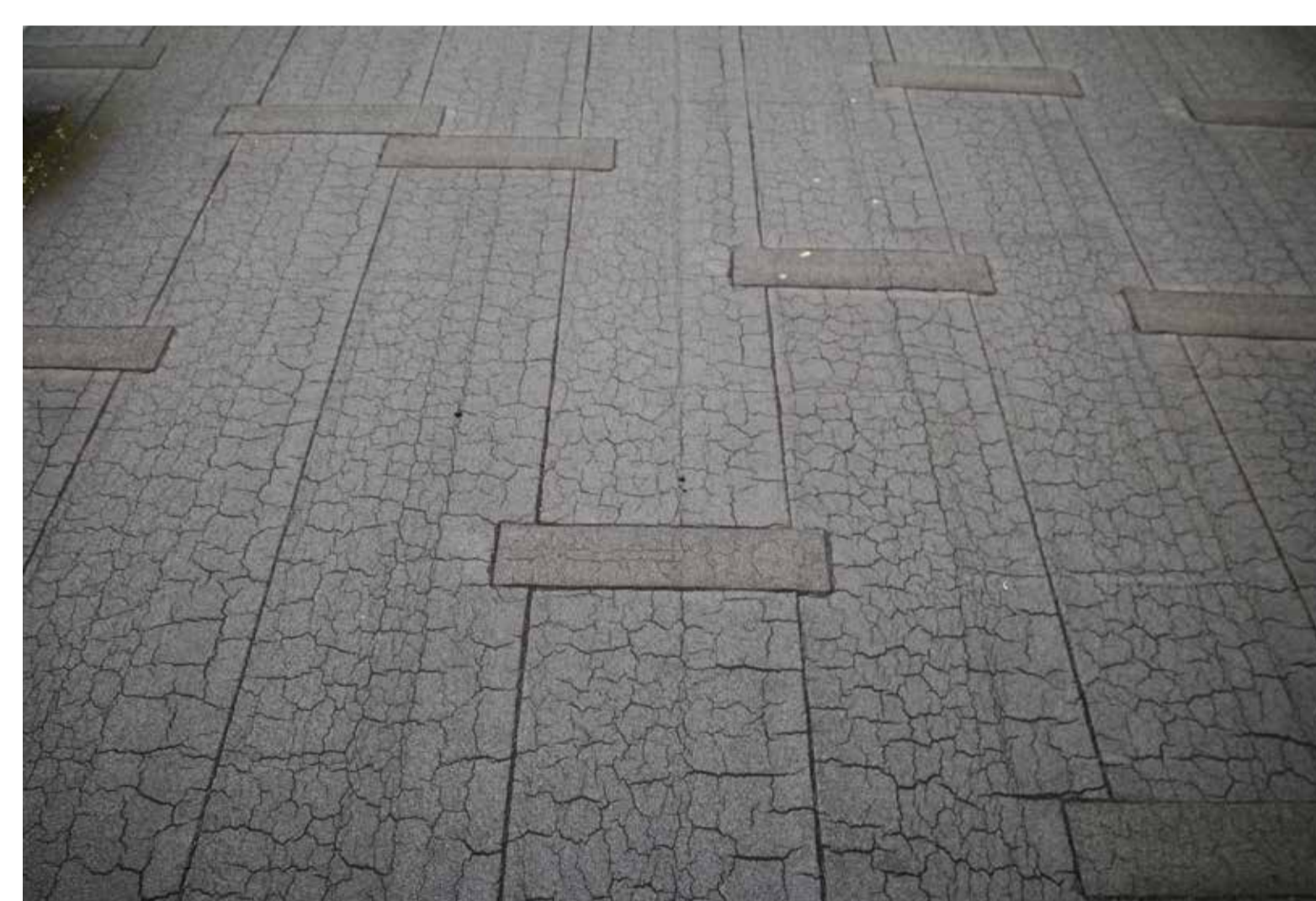
Krokodýling a přepáskované spoje u smrskávajících se asfaltových hydroizolací Crocodileing and strap repair over joints of shrinking asphalt DPCs
