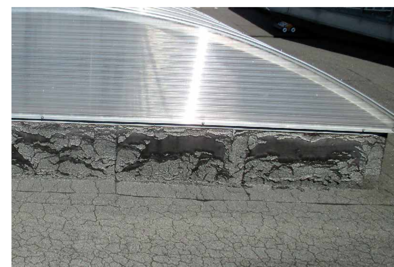
Stékající asfaltová izolace a krokodýling Sagging asphalt insulation and crocodileing
