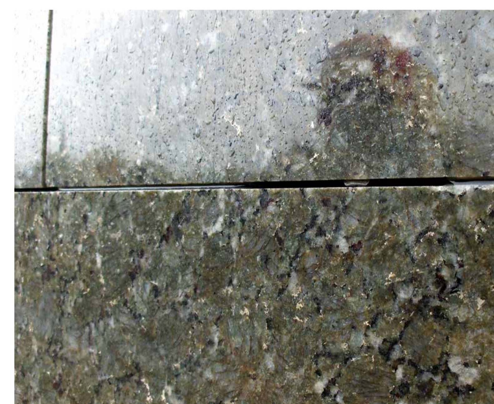
Voda ve spáře zavěšeného fasádního obkladu z kamenných desek – administrativní objekt v Olomouci Water in the joint of a stone veneer façade – an office building in Olomouc, the Czech Republic
