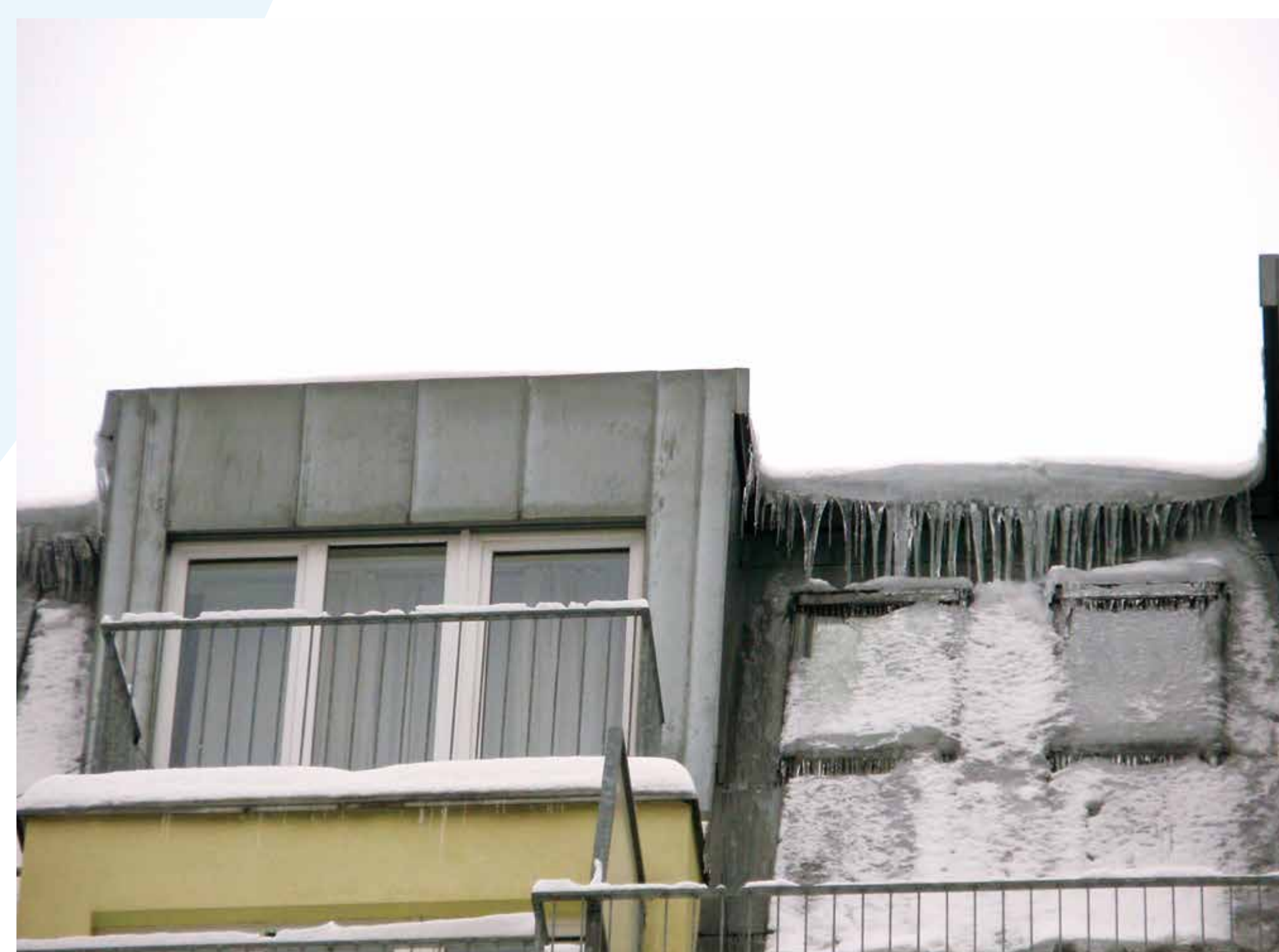
Voda z odtávajícího sněhu zmrzla na okraji střešy a vytvořila valy, za nimiž další voda nastoupala, aby působila tlakem na krytinu, která není pro takové hydrofyzikální namáhání navržena. Water from melting snow froze on the roof edge, creating dams behind which more water rose to compress the roofing that had not been designed for such hydro-physical loading.
