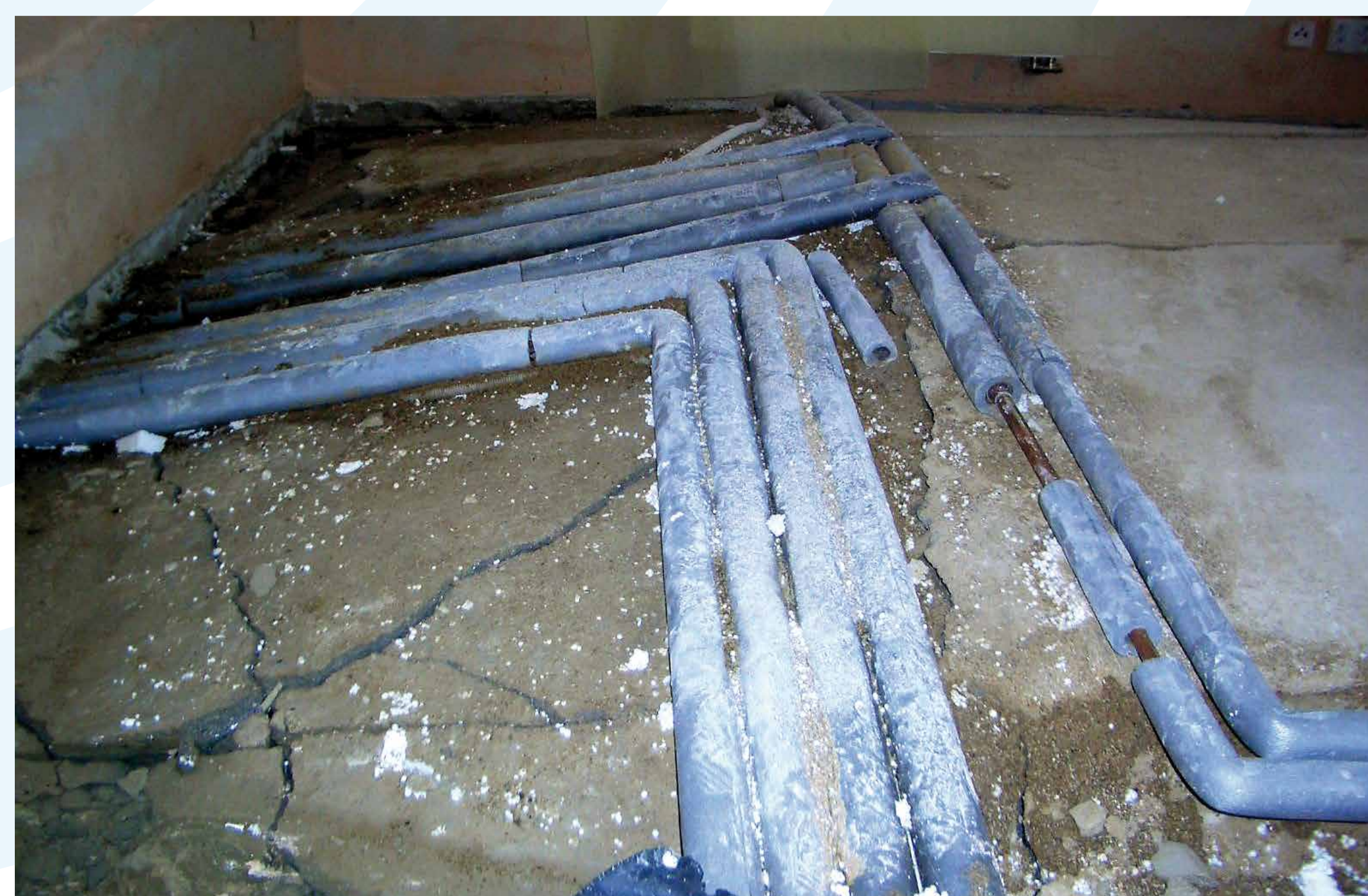
Vyduťtí konstrukce podlahy suterénu, způsobené nevhodným napojením drenážního potrubí do vsakovacího zařízení. Při naplnění vsakovacího zařízení v období příválových dešťů došlo ke zpětnému zalití drenáže a prostoru pod podlahou, s následným působením tlakové vody na konstrukci podlahy Buckled basement floor caused by an inappropriate connecting of a drainage pipe into a seepage pit. When the seepage pit was filled during torrential rains, the water flowed back into the drainage pipe and into the space below the floor, then pushed water onto the floor structure.
