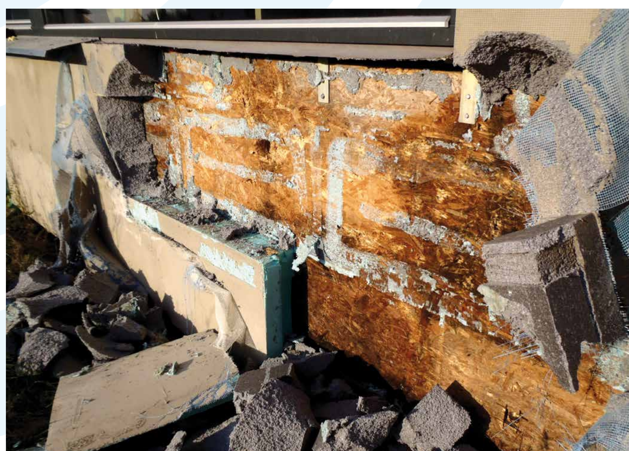
V případě dřevostavby je okenní parapet hydroizolační konstrukcí, po které se vyžaduje vysoká spolehlivost. Zatekání v koutě ostění způsobilo destrukci nosné konstrukce ještě před dokončením stavby. In timber frame structures, window plinths are a waterproofing structure requested expected to exhibit a very high degree of reliability. Leaking in the corner of the window lining destroyed the loadbearing structure even before completion.
