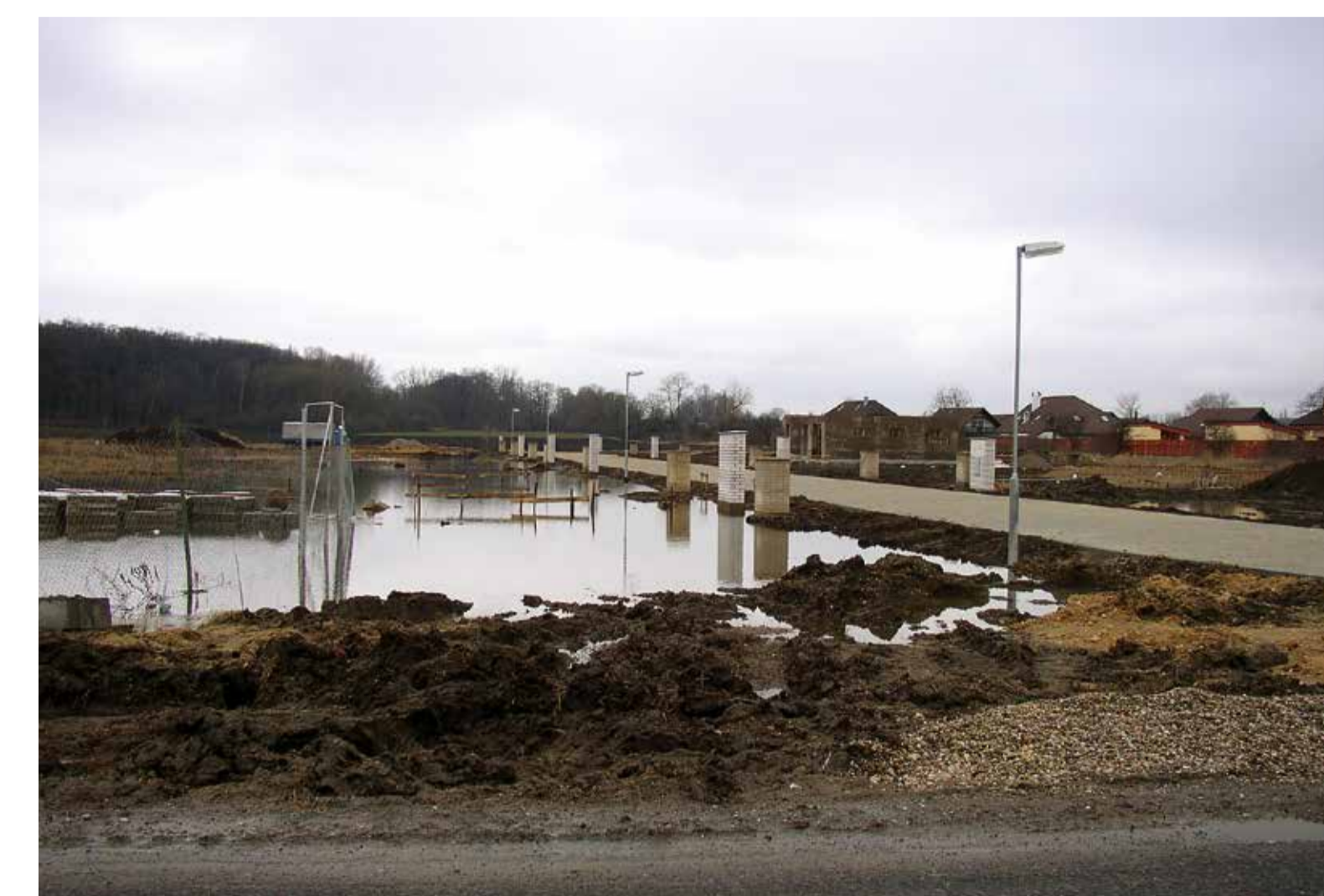
Zatopené staveniště – ne všude je vsakování možné Flooded site – absorption is not possible everywhere
