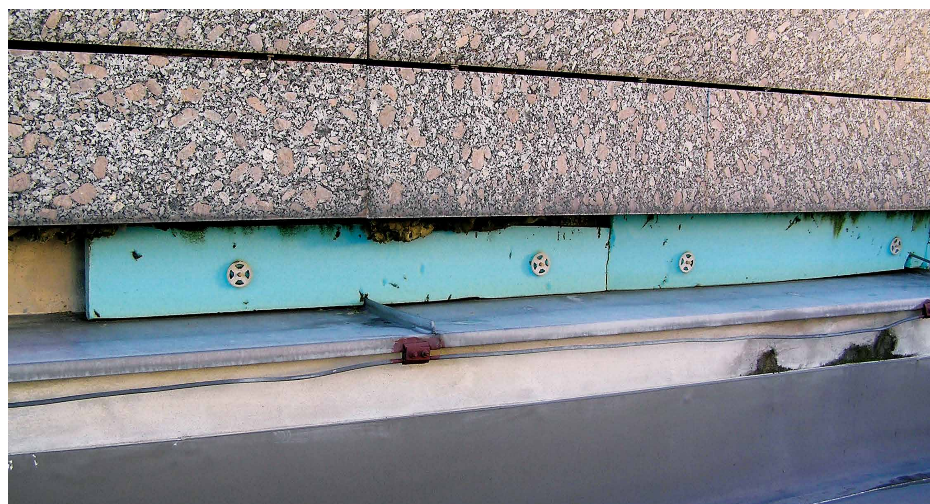
Větrm hnaný déšť pronikající spárami zavěšeného obkladu znehodnotil nechráněnou tepelnou izolaci z minerálních vláken. Ta se odtrhla od stěny a zborstila se do vzduchové vrstvy za obkladem. Rain-driven water penetrating through joints of a suspended cladding system damaged the unprotected mineral wool thermal insulation. It tore off the wall and collapsed into the air gap behind the cladding.
