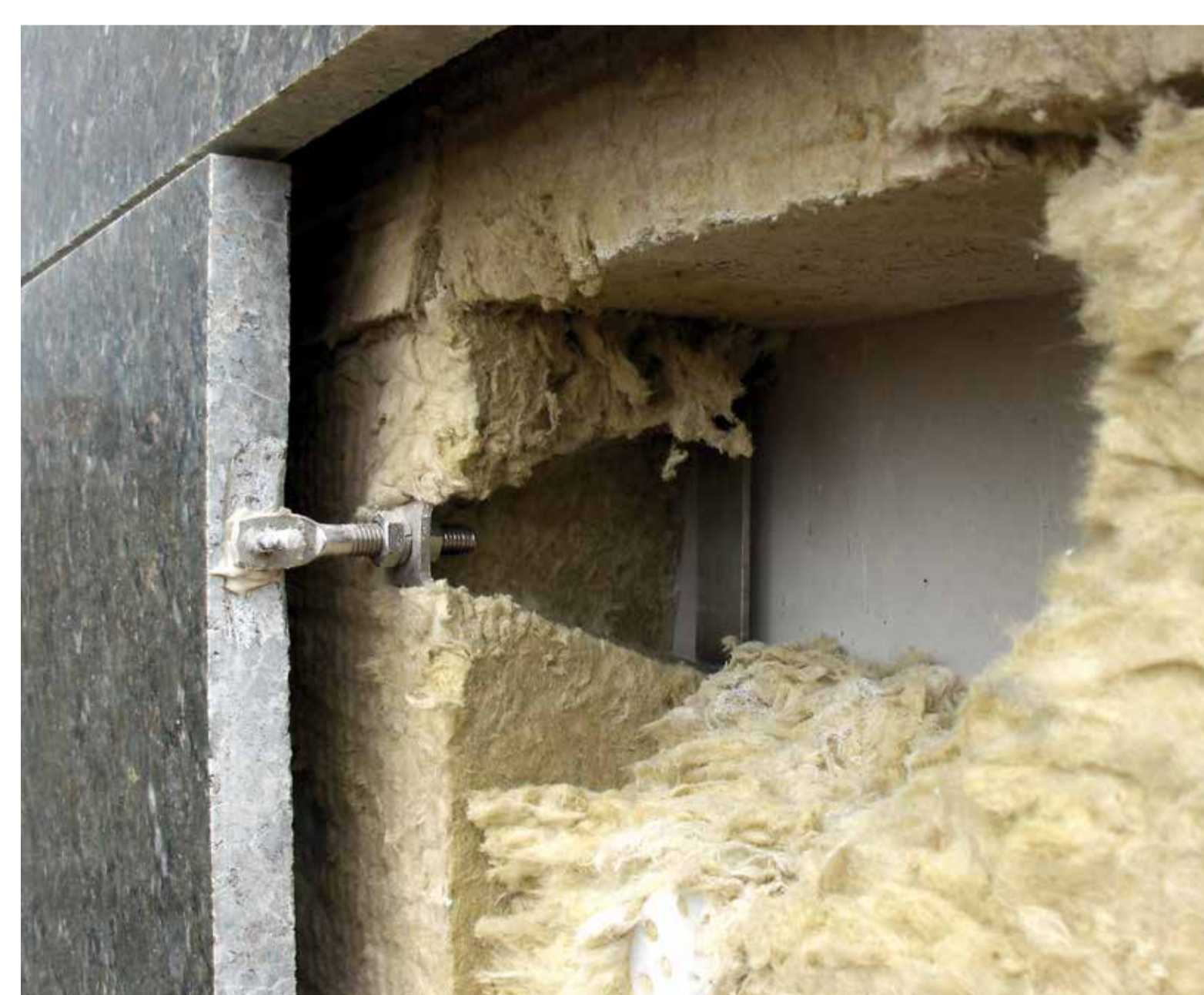
Absence hydroizolačních opatření ve skladbě konstrukce se skládaným vnějším pláštěm – administrativní objekt v Olomouci Absence of damp proofing in a rainscreen system – an office building in Olomouc, the Czech Republic
