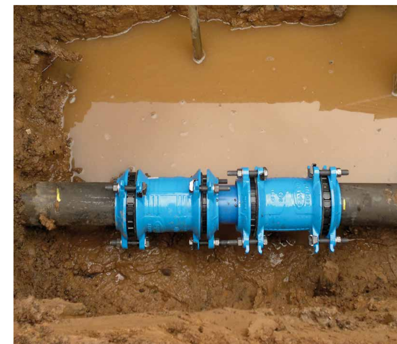
Ukázka způsobu opravy poruchy řadu DN150 na ul. Zahradní v Hlučíně Example of a repaired failure of a main DN150 in Zahradní street in Hlučín, the Czech Republic
