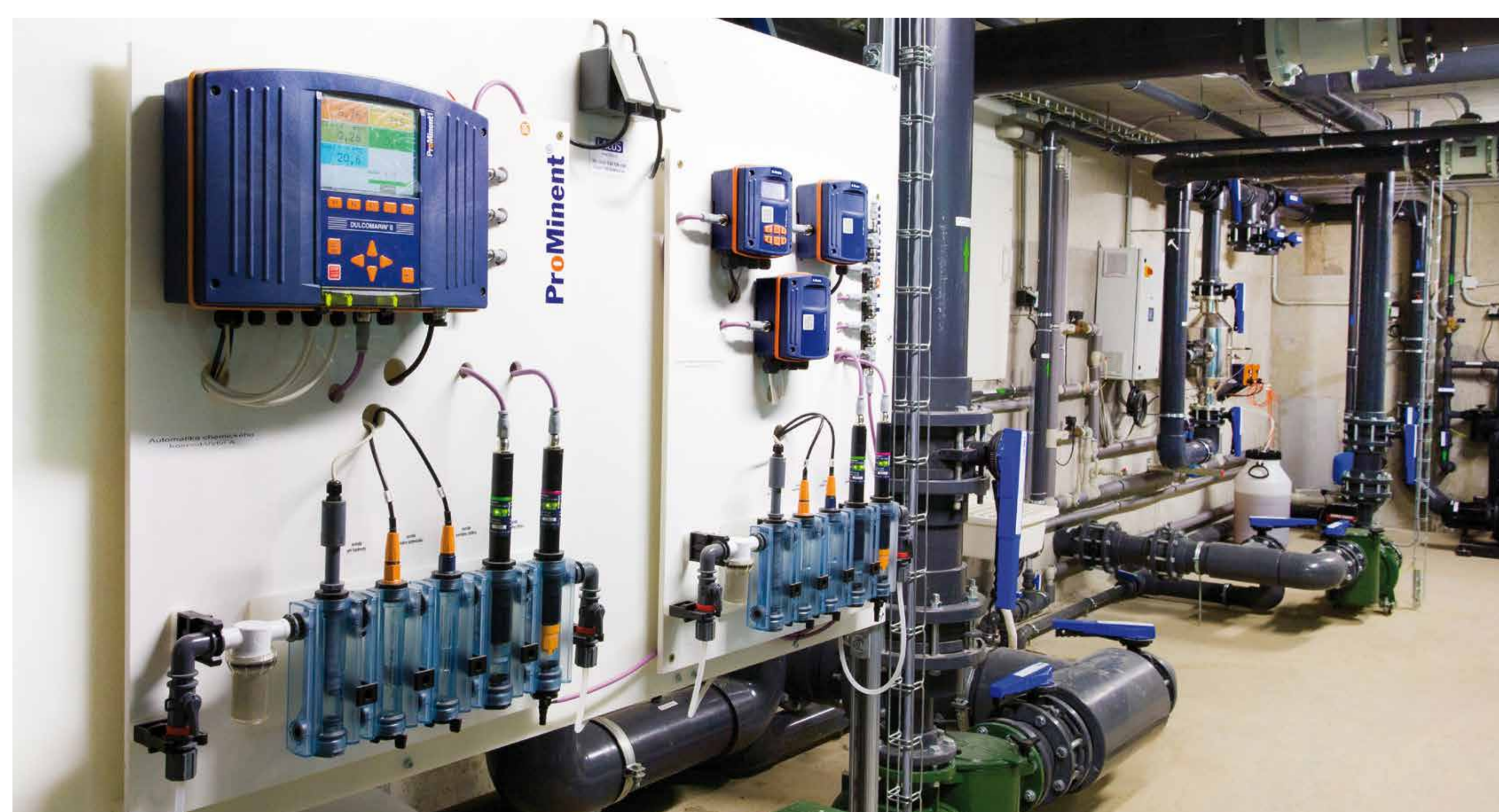
Průhled do strojovny bazénové technologie s dávkováním chlorové dezinfekce a dezinfekcí pomocí UV záření View to the swimming pool technology plant with chlorine and UV disinfection dosing technology
