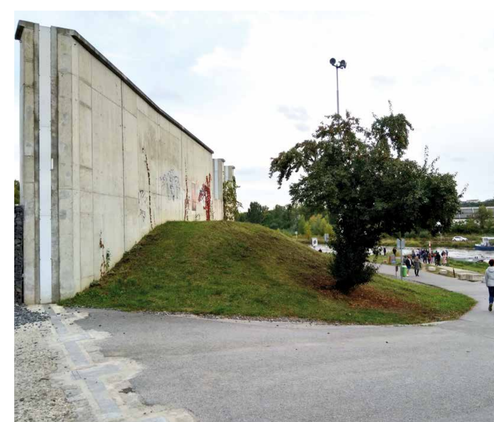
Protipovodňová ochrana vesnické památkové zóny Osada Rybáře u Trojského zámku, Praha Flood protection for the village monument protection zone Osada Rybáře near the Troja Palace, Prague, the Czech Republic
