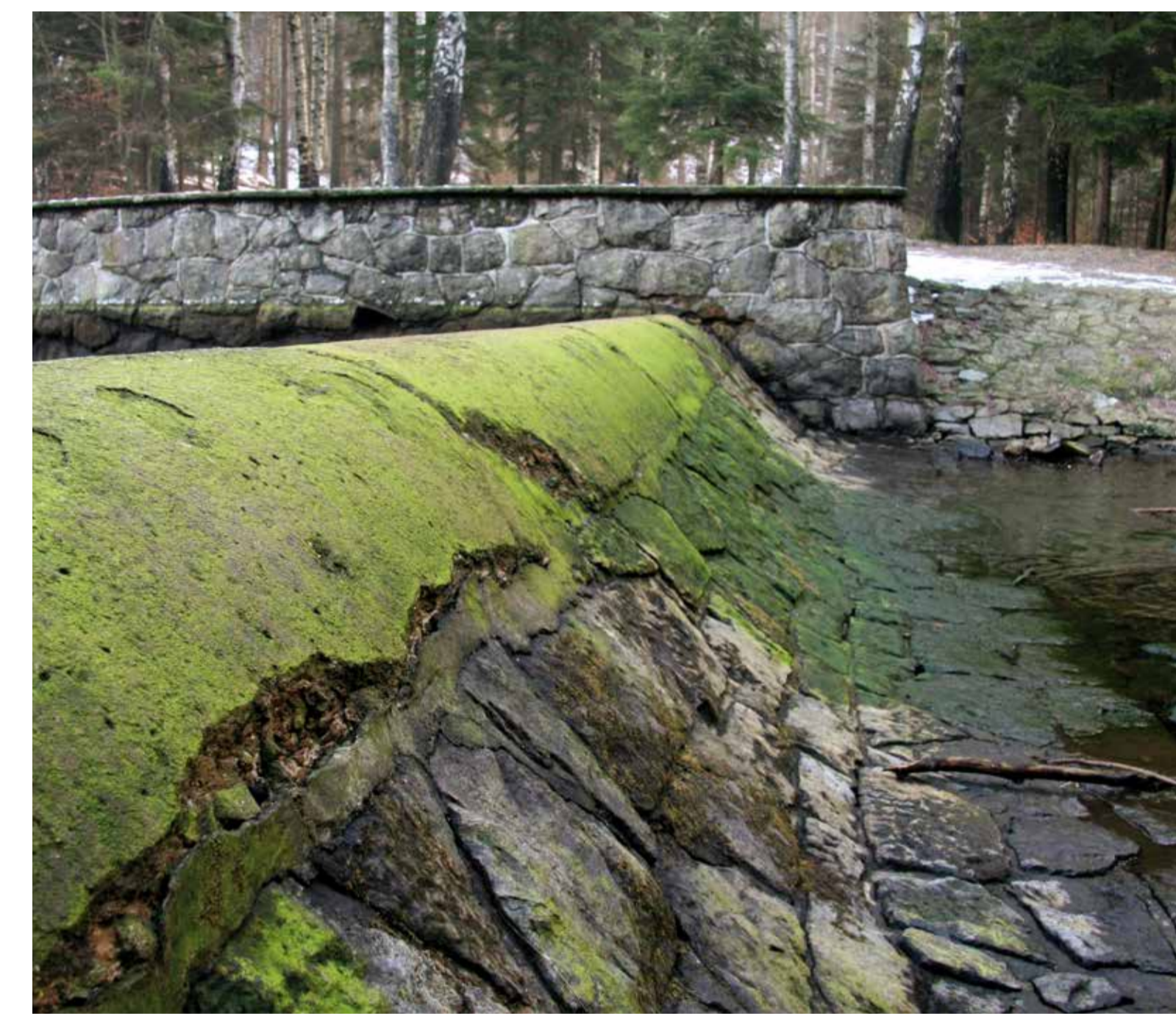
Detail přelivné hrany předpráhu, patrné porušení železobetonové konstrukce Detail of the subsidiary dam's crest of weir; noticeable damage to the reinforced concrete structure.
