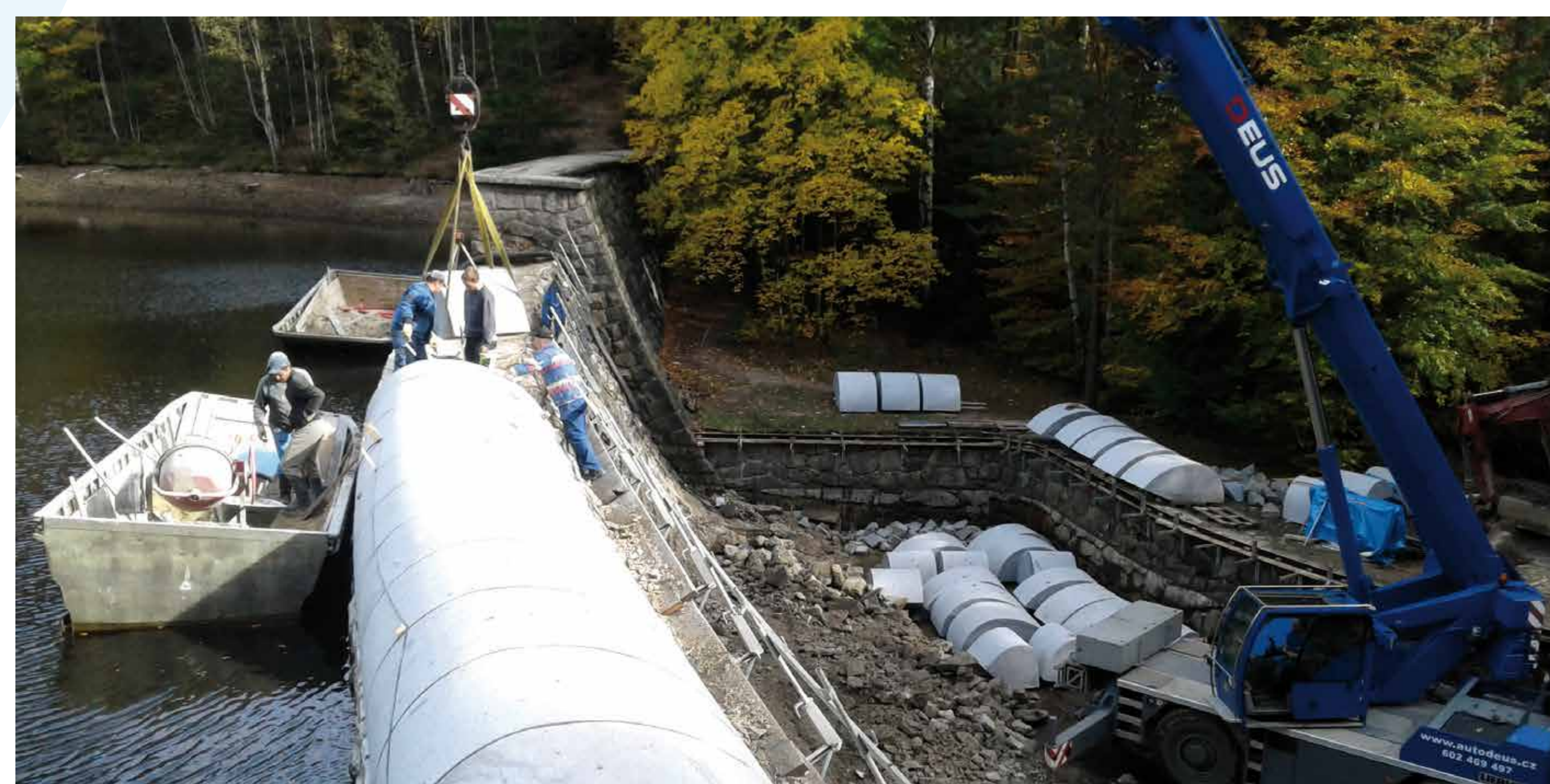
Ukládání kamenofezy na přeliv zděné hráze vodního díla Naděje Placing of semi-circular stones onto the spillway of a bricked dam of the Naděje Waterwork.
