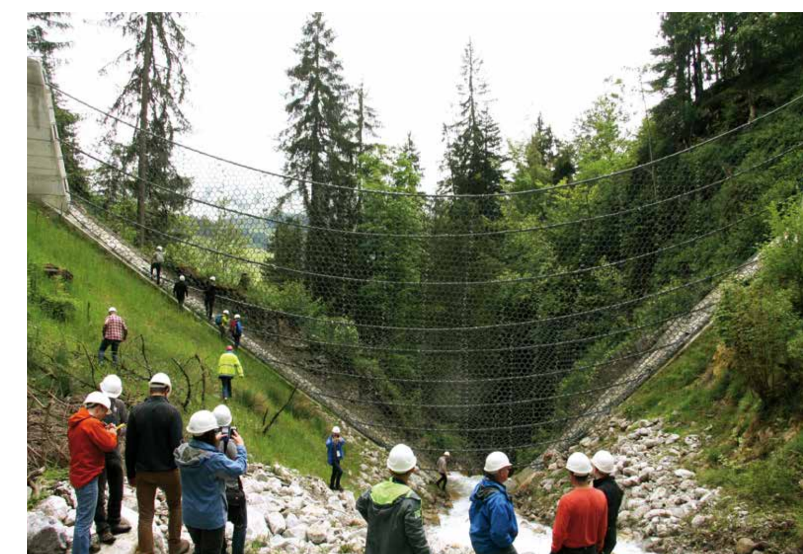
Flexibilní VX bariéra na toku Hüpach v kantonu Bern, retenční prostor pro zadržení 16 000 m 3 splavenin, konstrukční výška bariéry 20 m, nosná lana zavěšována pomocí helikoptéry Debris flow VX barrier for the Hüpach stream in the Canton of Bern; catchment space for the retention of 16,000 m 3 of sediment runoff, the barrier's structural height is 20 m; a helicopter is used to hang loadbearing cables.
